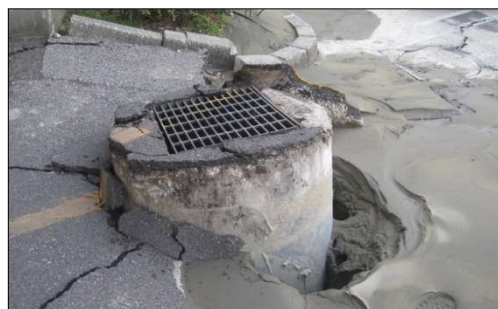
(写真1) 地面より高くなったマンホール
