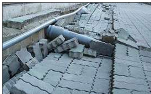
(写真2) 段差ができてむき出しになった配水管
