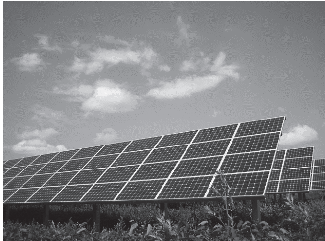
資料4 地面に設置されたソーラーパネル
